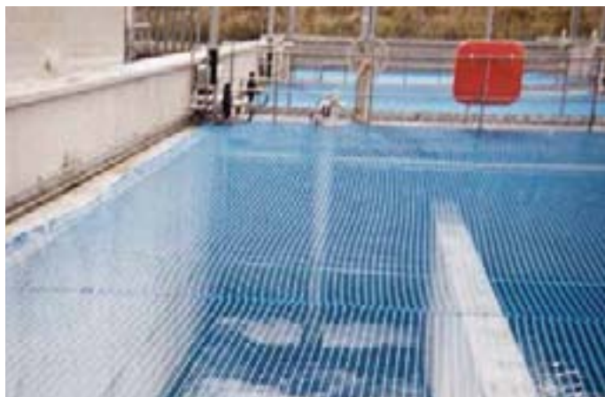
Filet de sécurité sur un bassin d'épuration
